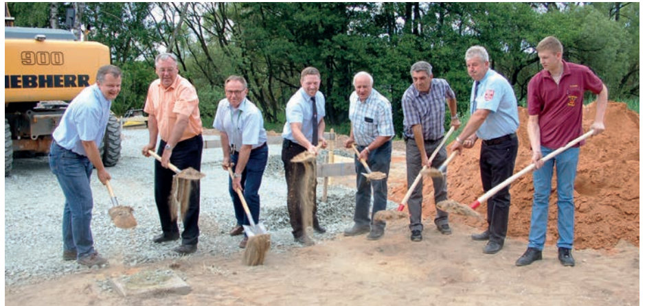
Der Spatenstich für den Neubau des Feuerwehr-Geräteshauses in Gmünd. Unser Bild zeigt von links: Dritter Bürgermeister Thomas Schopf, erster Bürgermeister Helmuth Wächter, Architekt Wolfgang Schultes, Kommandant Tobias Schatz, Josef Neubauer, Gerhard Stümpfl, Vorsitzender Herbert Dobmann und Florian Arnold. Bild: Renate Gradl
