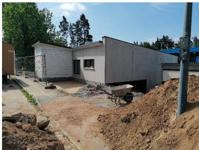
Das neue Technikgebäude erscheint zwar äußerlich eher unscheinbar, verbirgt aber aufwendige Installationen. Bild: Stadt Grafenwöhr
